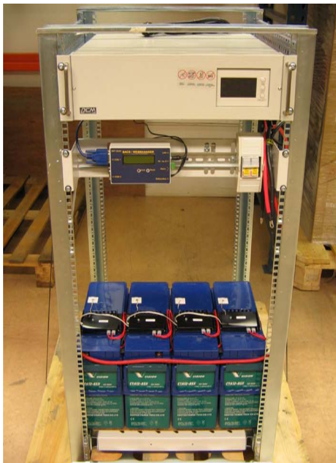
BACS monterad i rack
